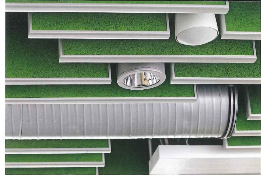
Optischer Vorteil. Be- und Entlüftungsrohre, Kabelkanäle, Leitungen und sogar Lautsprecherboxen und Leuchten lassen sich unaufdringlich in die Akustiklösung mit Baffeln integrieren.
